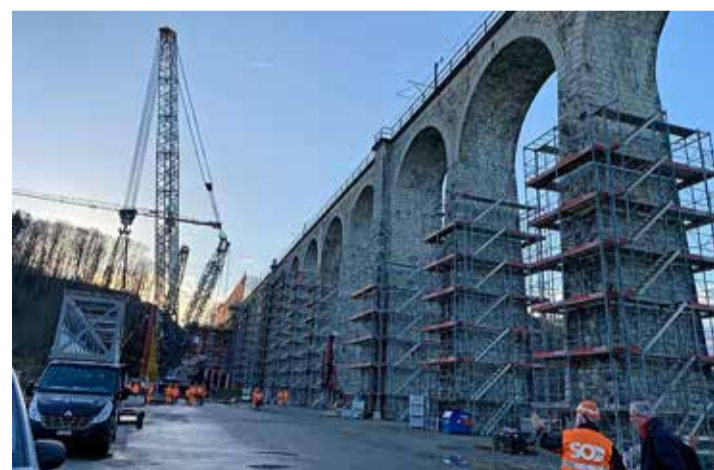
Der denkmalgeschützte Viadukt wird grundlegend saniert. Bild Margrit Sixt
